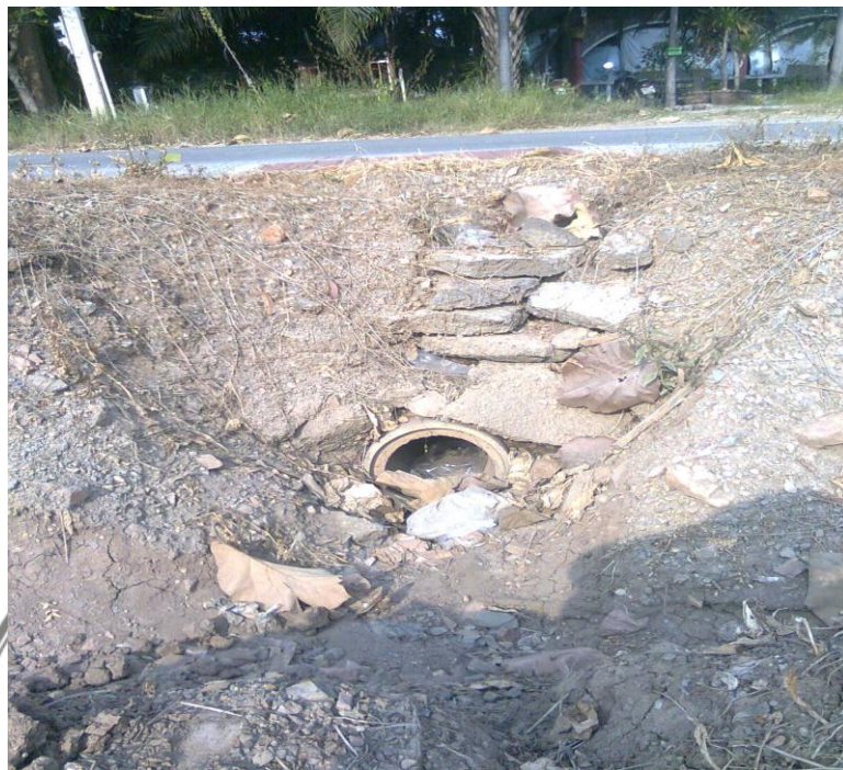
ภาพที่ 9 ท่อระบายน้ำ
