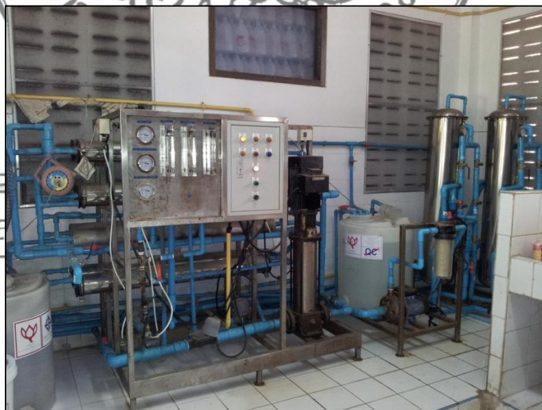
แผงควบคุมการทำงานของกระบวนการผลิตน้ำดื่ม
