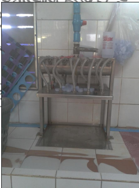
พื้นที่บริเวณเครื่องบรรจุน้ำดื่มชนิดขวดขุ่น
